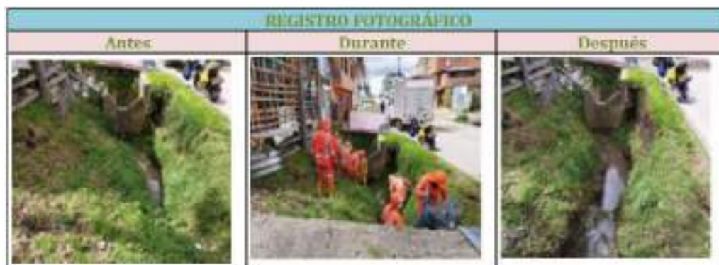
Figura 37 Registro fotográfico Quebrada la Sureña
