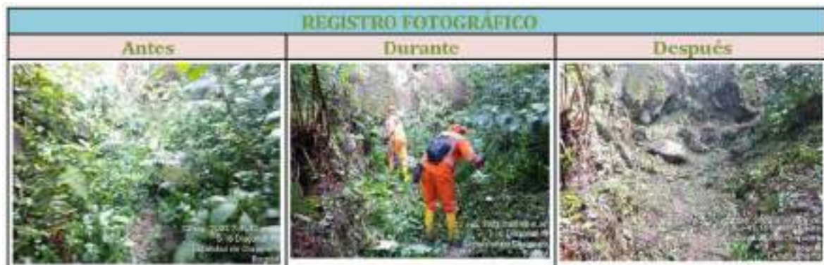
Figura 29 Registro fotográfico Desarenador Quebrada el Chulo
