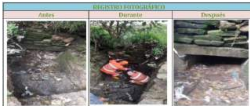
Figura 35 Registro fotográfico Quebrada Puente de Piedra
